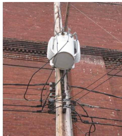
East Alley NIPSCO Pole-Mtd Transformer
