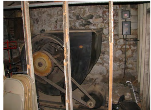
Existing Auditorium Supply Fan
